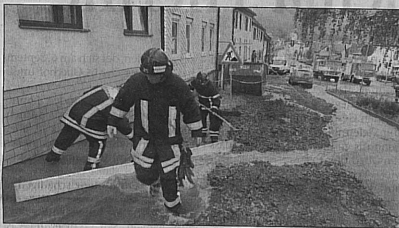
Die Feuerwehrleute bauten mit Brettern Sperren und versuchten, Wasser und Geröll – vor allem die Frostschutzsperre aus der Straßendecke – zu kanalisieren.
