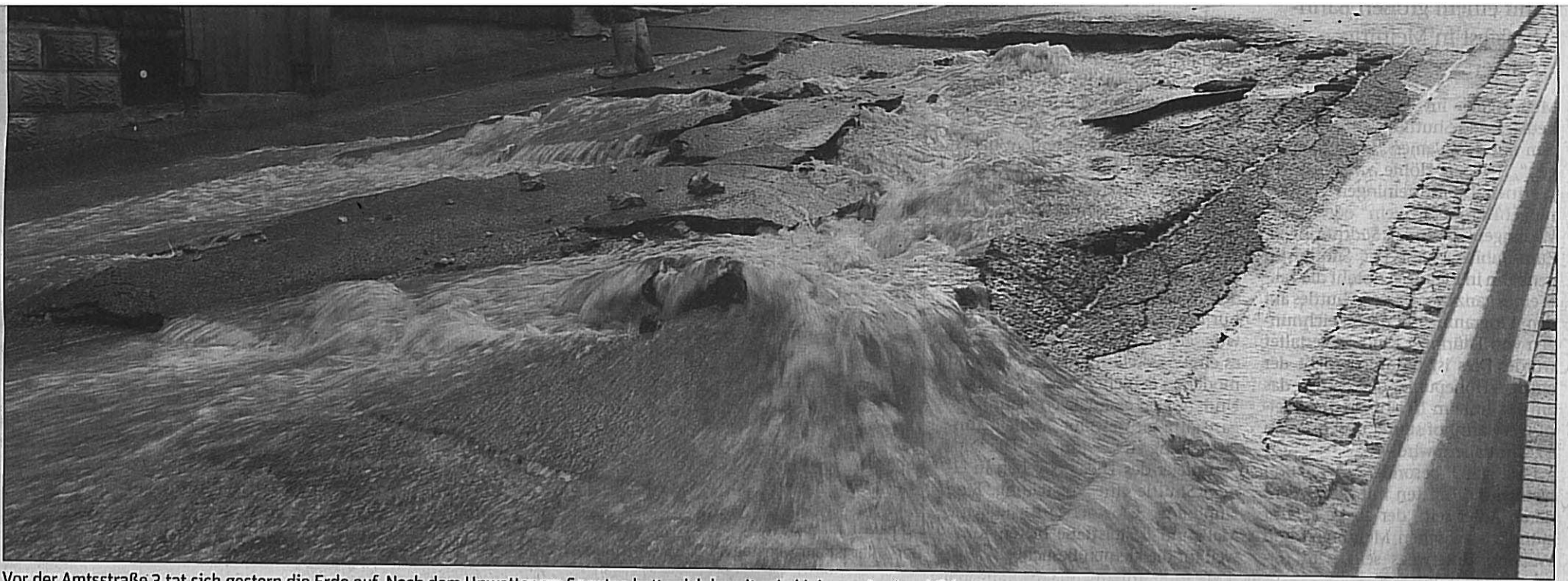
Vor der Amtsstraße 3 tat sich gestern die Erde auf. Nach dem Unwetter am Sonntag hatte sich bereits ein kleineres Loch gebildet, gestern zerbarst die Asphaltdecke nach einem Kanalbruch des Mischwasser-sammlers auf der gesamten Straßenbreite. Der Schotter der Forstschutzschicht ergoss sich bis auf die Oberhofer Straße.
